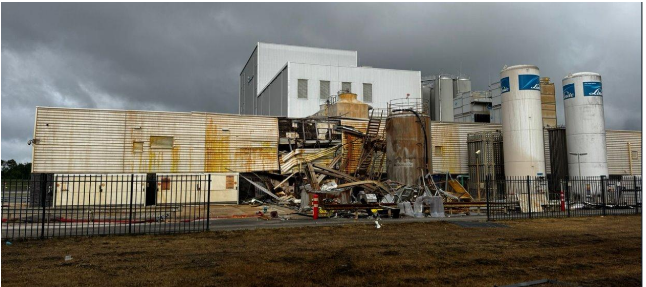
Schade aan de installaties
